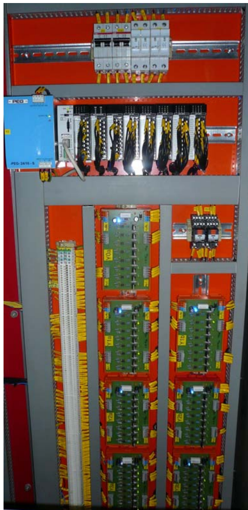
Obrázek 1 Řídicí systém – výstroj rozváděče
